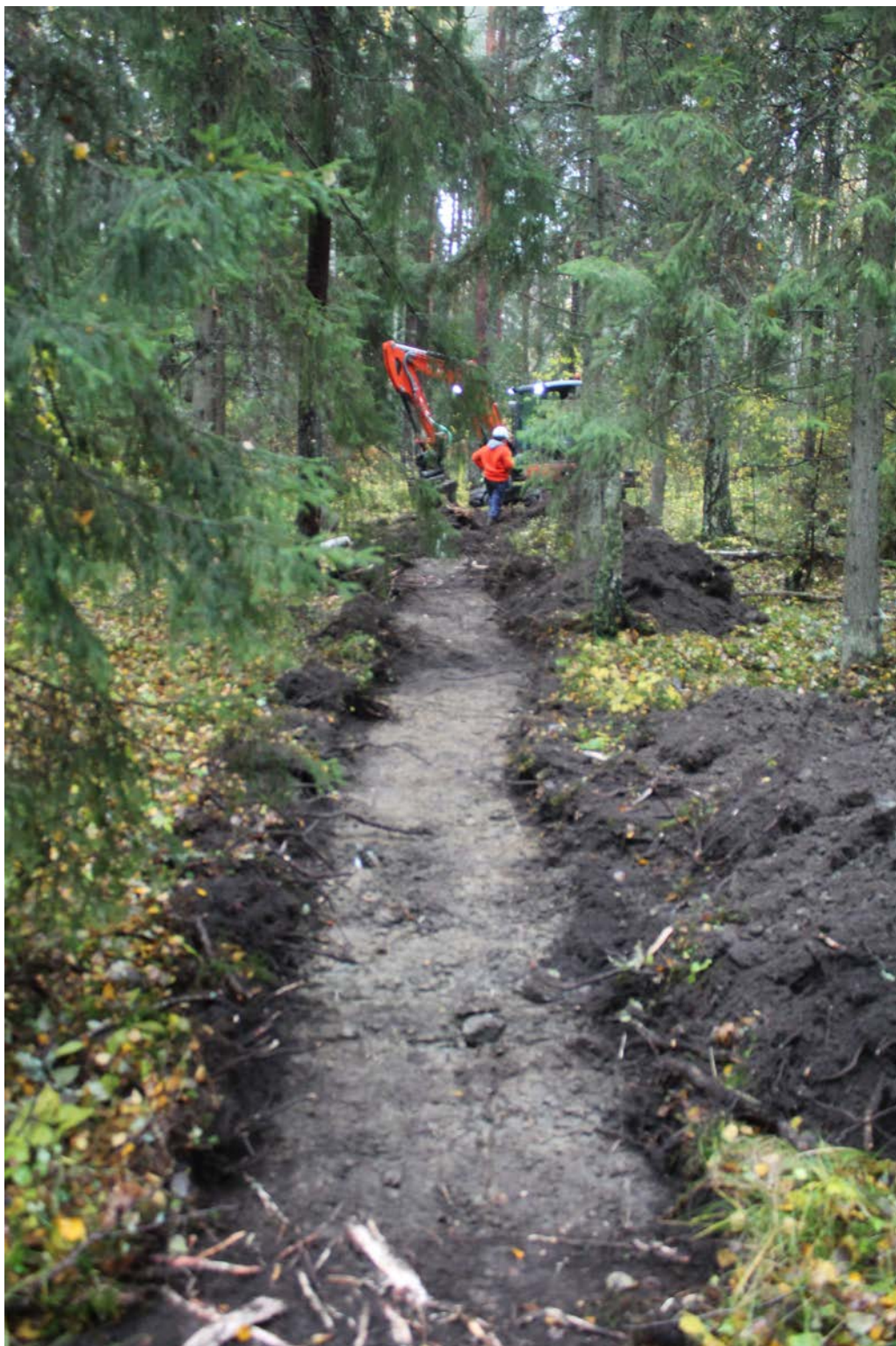
FIGUR 15. Sökschakt grävdes med maskin inom några planare ytor med underlag av lera. Foto. Jonas Wikborg, SAU.
