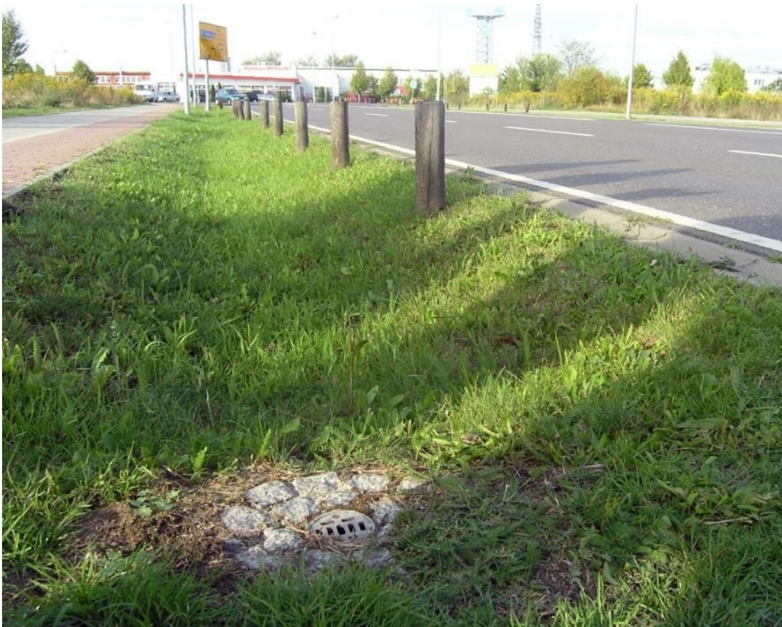
Figur 20. Exempel på svackdike i Uppsala med en lätt förhöjd brunn för att skapa fördröjningsvolym. Foton: WRS.
