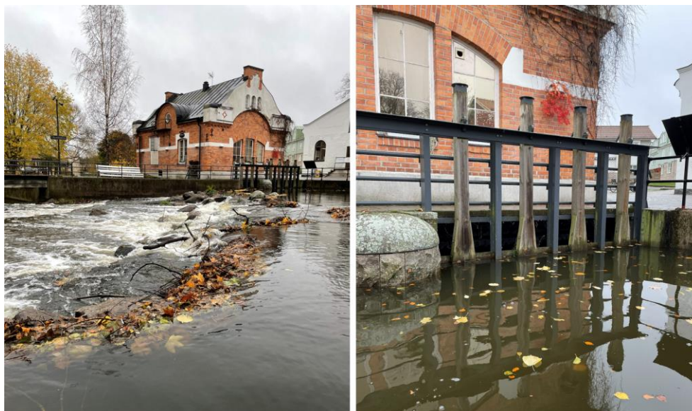
Figur 3-2: Bild över tröskel och den gamla kraftstationen vid Kvarnholmen (vänster) samt luckorna (höger). Foto: DHI
