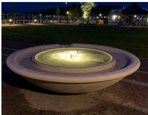
Figur 408. Upplyst vattenspel. Bildkälla: Sydväst
