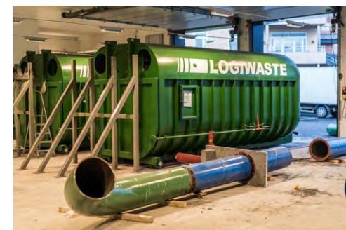
Figur 124. Sopsugscentral vid Roslagens sjukhus. Bildkälla: Norrtälje kommun
