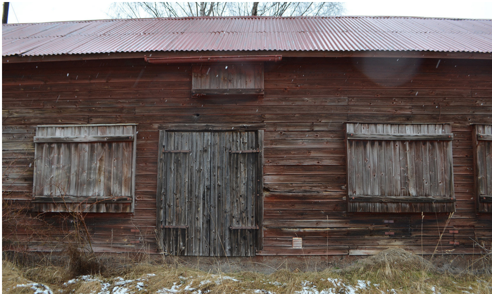
Figur 12. Hönshus med igenbommade fönster. Foto mot norr av Helén Sjökvist.
