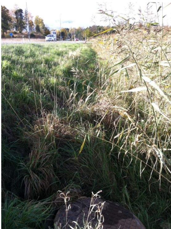
Bild 3. Trasigt brunnslock, vassrugg utmed Vätövägen
