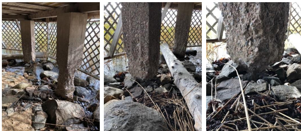
Erosionsskador på bärande konstruktion. Foto: Norrtälje kommun
