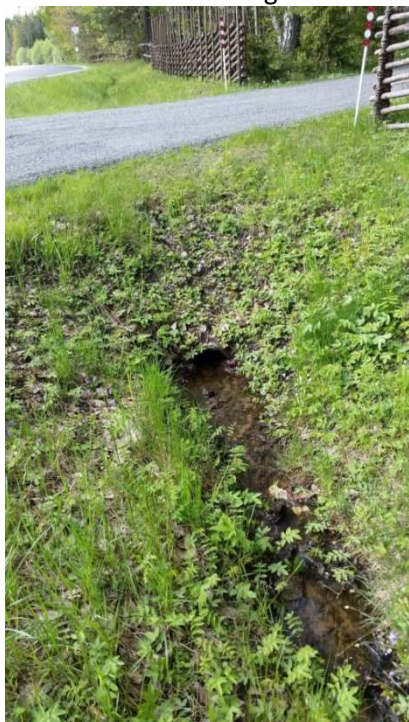
Figur 3:51. Vägtrumma i dåligt skick under infart längs länsväg 276
