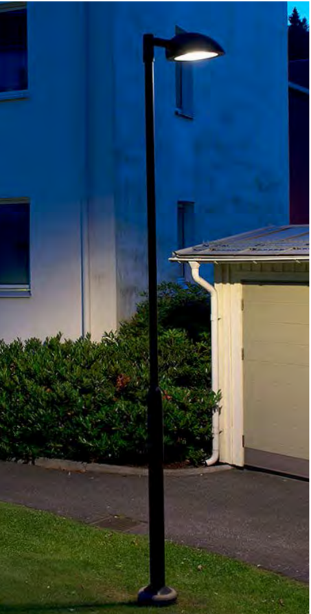
Stolpbelysning Vialume 75 från Fagerhult på avtrappad stolpe.
