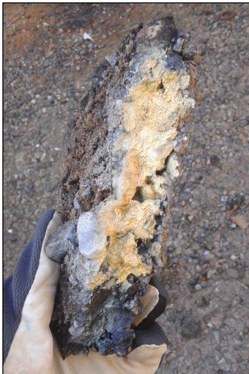
Utslag av PAH-spray på asfalt, som indikerar höga halter PAH-innehåll (tjärasfalt).
