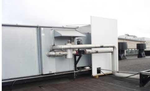
Figur 10 Exempel på avskärmning av utblås från fläktaggregat.
