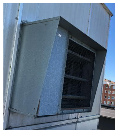
Figur 8 Fläktaggregat, galler mot parkering.
