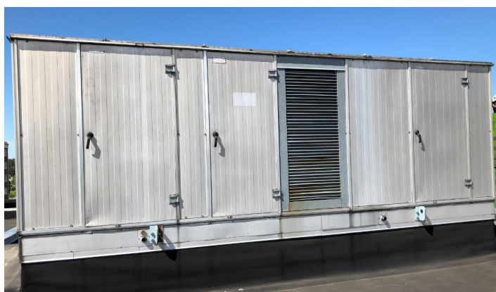
Figur 7 Fläktaggregat på tak (galler mot Estunavägen).
