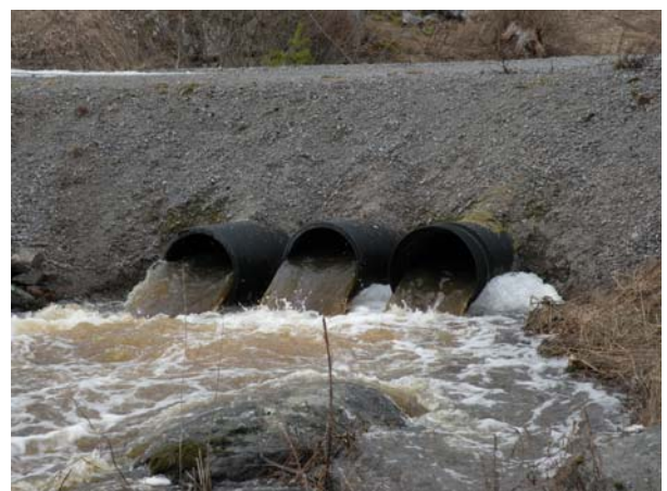
42) Högt placerad kulvert, vandringshinder för de flesta djur, Näfsån vid Brollsta
